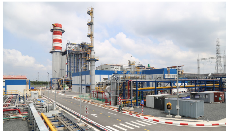
Nhà máy điện khí LNG Nhơn Trạch 3 và 4 là mắt xích quan trọng trong chuỗi khí - điện LNG khép kín
